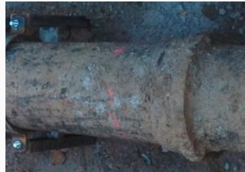
Bleimuffe: Originaleinbauzustand in Bergisch Gladbach vor der Sanierung Objekt „Strunde hoch vier“. Quelle: Detlef Schaupp, Büchel Rohr- und Tiefbau GmbH
